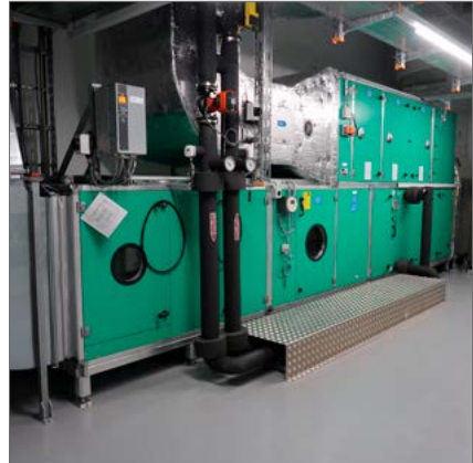
Centrale de ventilation moderne
